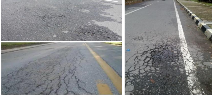
Gambar III.18 Retak Rambut ( Hair Cracks ) dan Retak Kulit Buaya ( Alligator Cracks )
