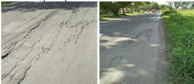
Gambar III.20 Alur ( Ruts ) dengan Retakan
