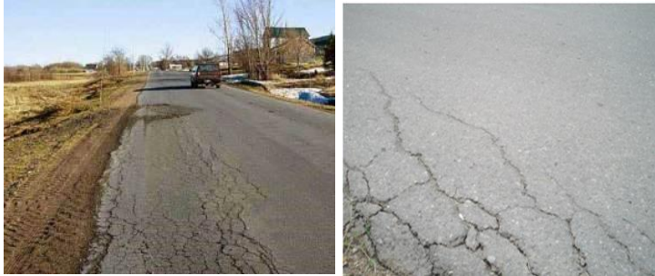
Gambar III.21 Kerusakan Tepi ( Edge Break )
