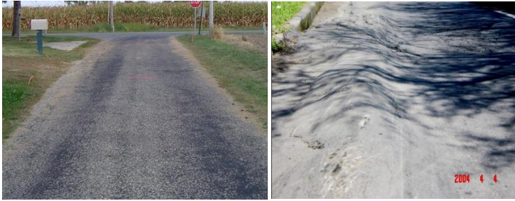
Gambar 3. 16 Kegemukan Aspal ( Bleeding ) Sumber: DPU Kulonprogo dan Burhamtoro
