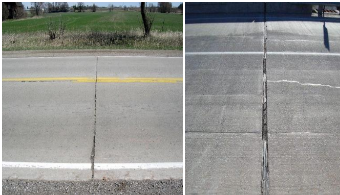
Gambar 3. 31 Kerusakan pengisi celah melintang ( Transverse Joints ) Sumber: Google
