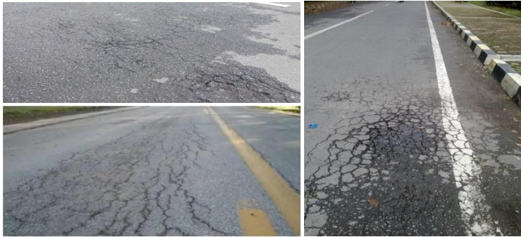
Gambar 3. 18 Retak Rambut (Hair Cracks) dan Retak Kulit Buaya (Alligator Cracks)
