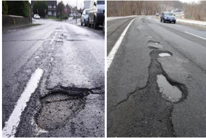
Gambar 3. 23 Lubang lubang (Pot Holes) Sumber: Google
