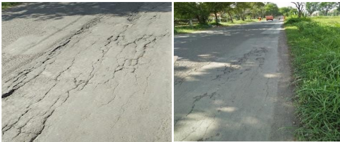
Gambar 3. 20 Alur ( Ruts ) dengan Retakan Sumber: DPU Kulon Progo
